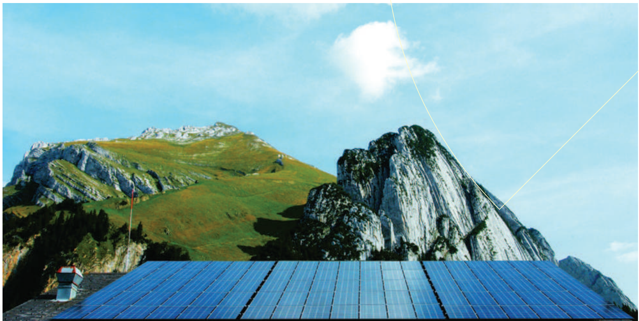
Leyenda de la foto: Instalación fotovoltaica en montaña. © Kyocera Fineceramics, Stromaufwart Photovoltaik GmbH
